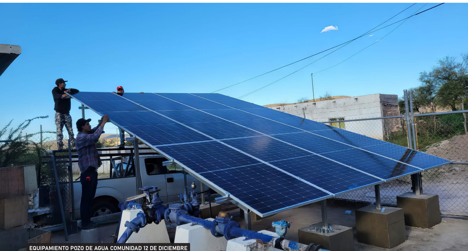
EQUIPAMIENTO POZO DE AGUA COMUNIDAD 12 DE DICIEMBRE
